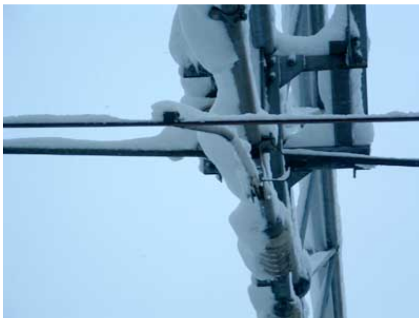
架線構造物に付着した雪 これが増大して落下する。
