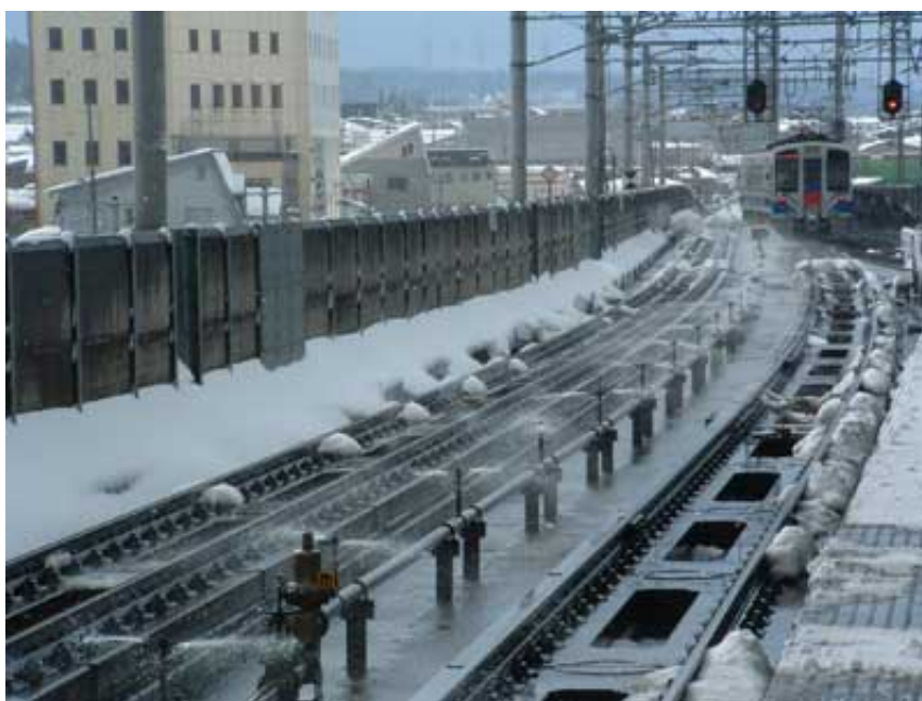
スプリンクラー稼動状況 (十日町駅構内)
