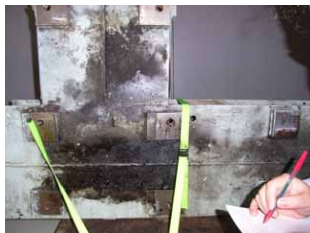
マシンベッドには、オイル汚れ及びブレーキライニングの摩耗粉と思われる黒い粉が付着していた。
